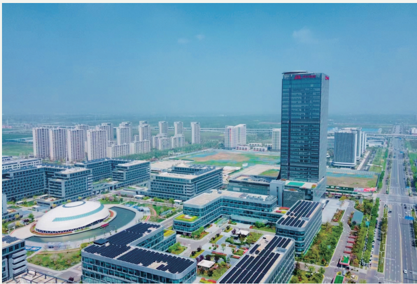
▲ 京东全球客服中心 123 号园区分布式光伏发电项目正在江苏宿迁建设中
